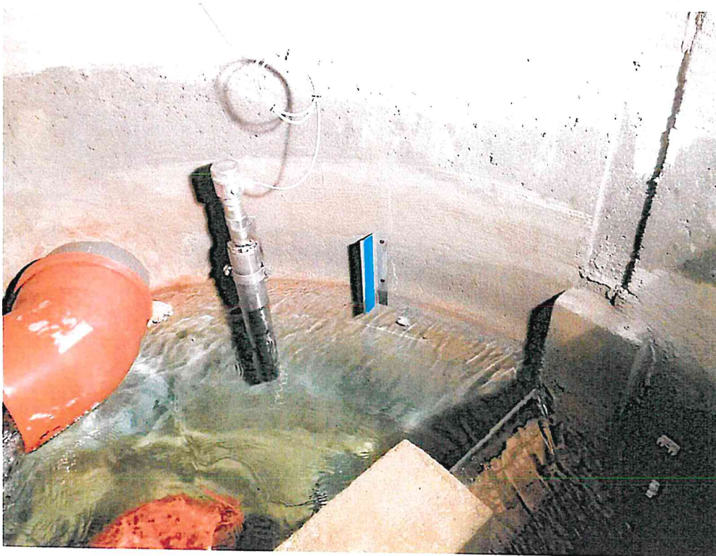
Bild: Quellzulauf und Überlauf mit Durchflussmessung (Überwasser zum Bach)
